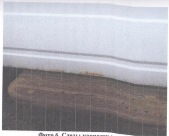
Фото 6. Следы коррозии ступенек
